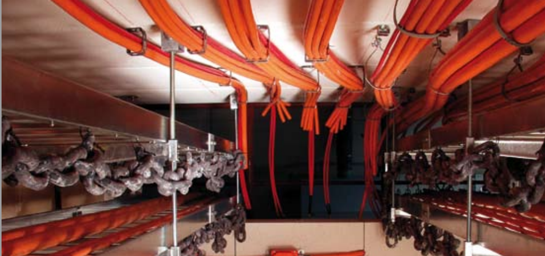
Versuchsaufbau einer Kabelprüfung zum Funktionserhalt (Anerkannter Prüfofen der DMT)
