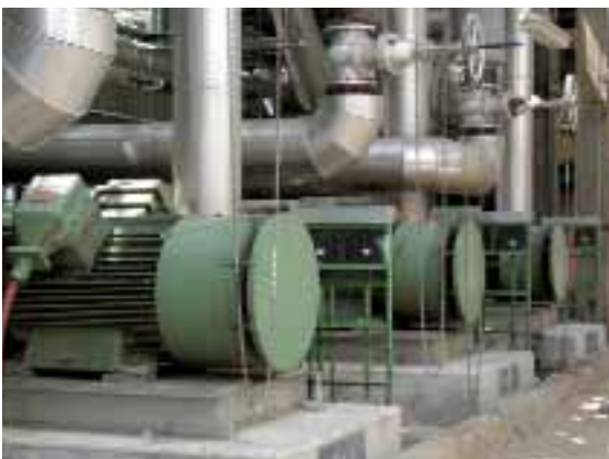
Pumpenbatterie in einer petrochemischen Anlage
