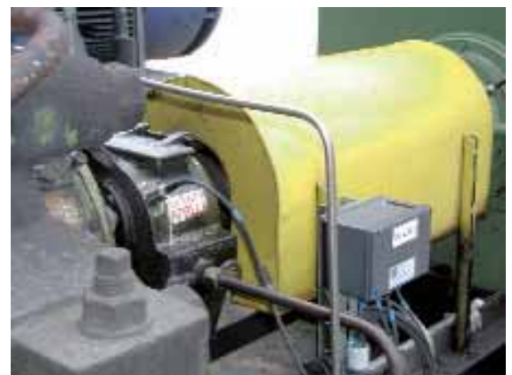
Sensor und Verteiler an der Pumpe
