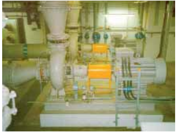
Zwischenkühlwasserpumpe eines 800 MW Braunkohlekraftwerkes
