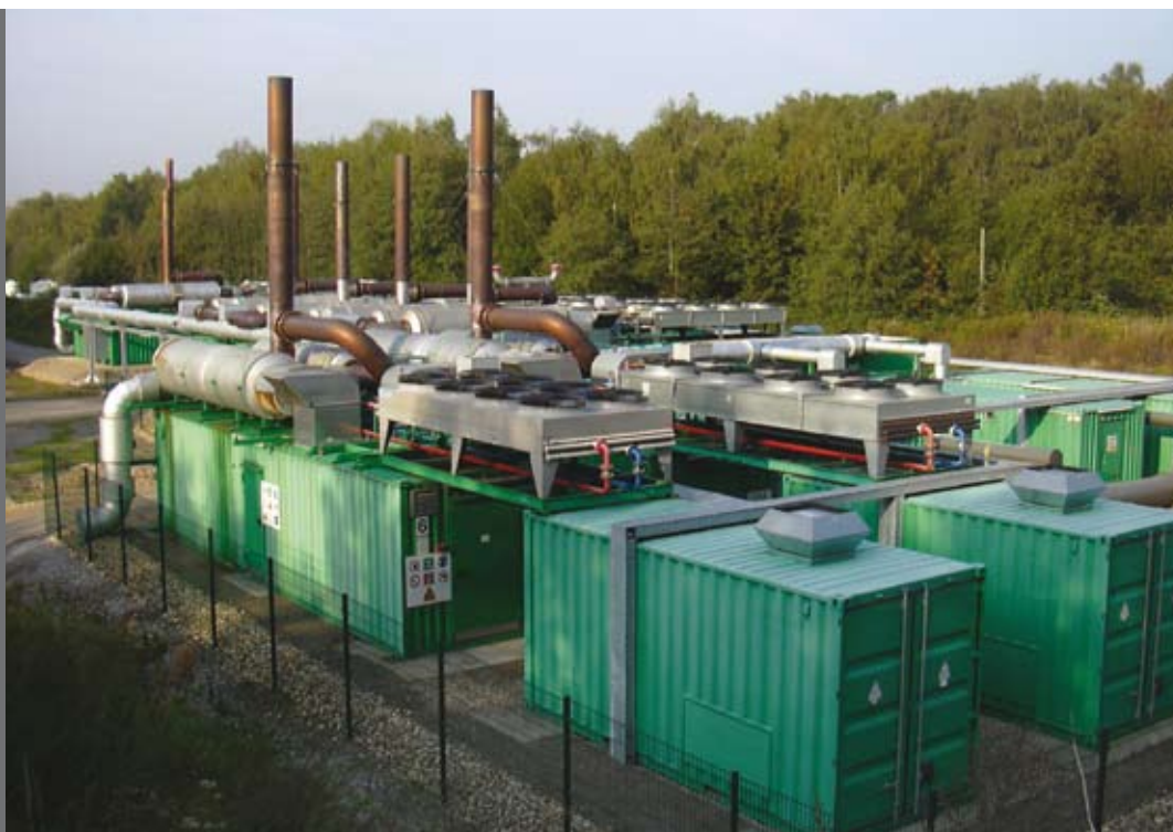
Когенерационная станция из модулей контейнерного типа (Minegas GmbH)
