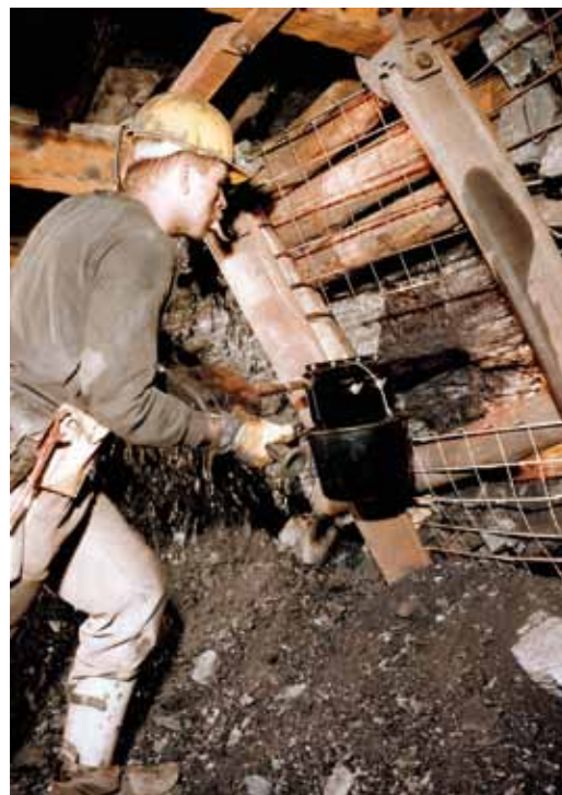
Taladrado de ensayo – Detección de un peligro de derrumbamiento de rocas
